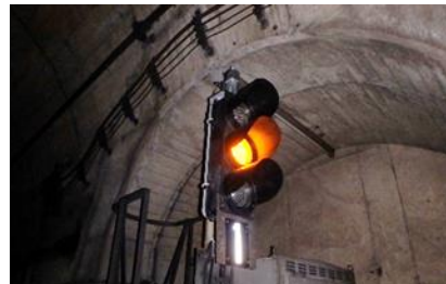
閉そく信号機(トンネル内)
