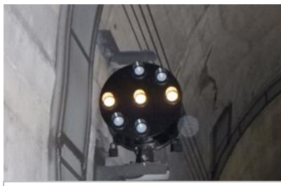
中継信号機(少限界用(トンネル内))
