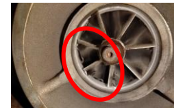
破損箇所（過給機内部）
