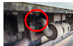
過給機設置箇所（車両床下）
