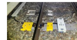
更新した ATS-P装置
