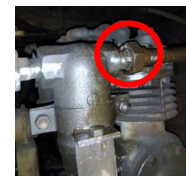
空気圧縮機ドレン分油器（車両床下）
