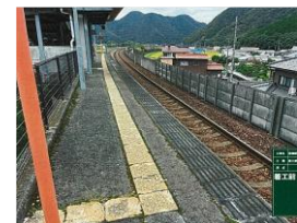
ホーム修繕（施工前）
