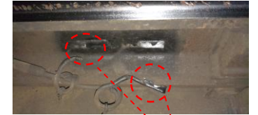
脱落した送着ボンド
